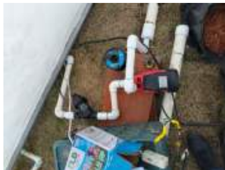
Fig. 1. Sistema de Riego, con bomba de agua y filtro.
